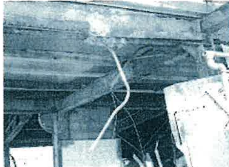
建物に残存した吹付け材
